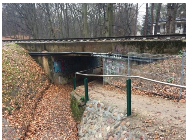
Fotografia 202. Miejsce wymagające poprawy stanu ładu przestrzennego – przejście pod torami (częściowo wyremontowane) Fotografia własna
