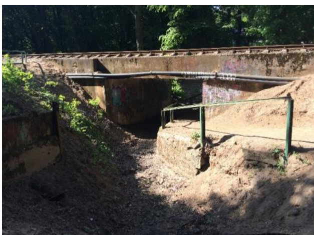
Fotografia 201. Miejsce wymagające poprawy stanu ładu przestrzennego – przejście pod torami Fotografia własna
