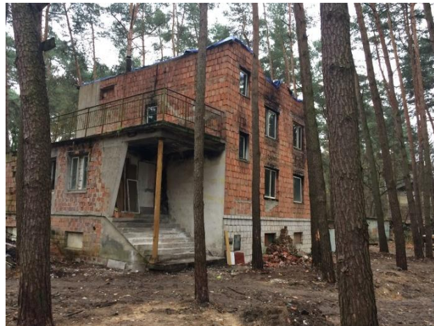
Fotografia 204. Miejsce wymagające poprawy stanu ładu przestrzennego: ulica Cicha – zniszczony budynek oraz składowisko odpadów (w trakcie porządkowania)
