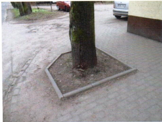
Fot.9: Symboliczna misa i uszkodzenie odziomka.
