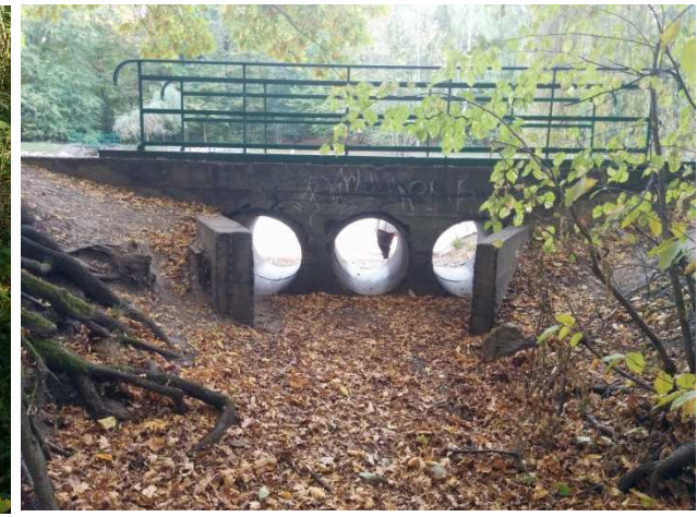
Fot. 3. Wylot ze zbiornika w Podkowie Leśnej do rowu RS-11
