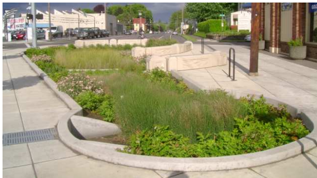
Zdjęcie 34. Ogródek deszczowy z widocznym wypustem z systemu odwadnianych dróg
