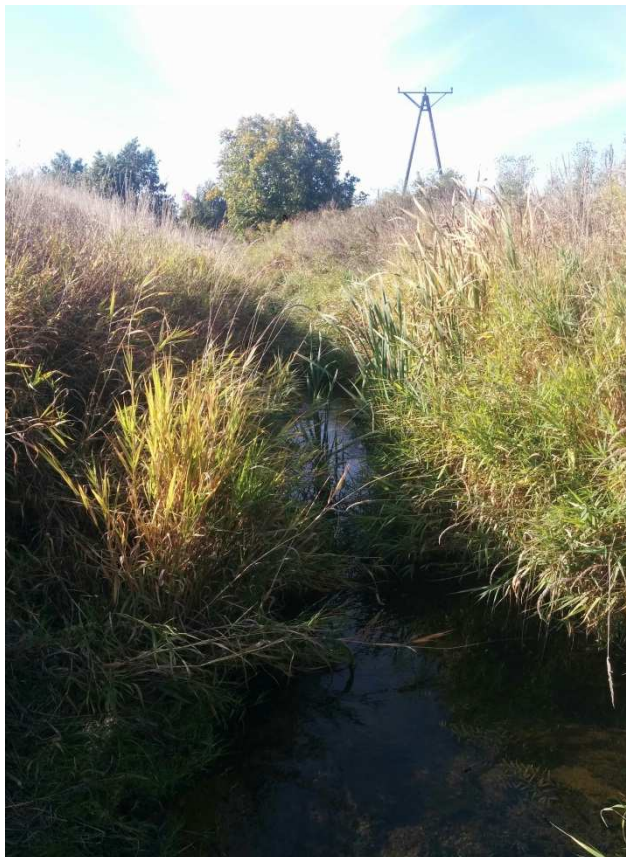
Zdjęcie 7. Silnie zarośnięty odcinek koryta Zimnej Wody wzdłuż ul. Nadrzeczej w Brwinowie
